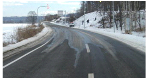
一部凍結した道路
