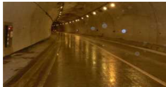
一部凍結したトンネル
