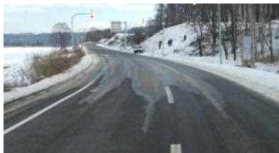
一部凍結した道路
