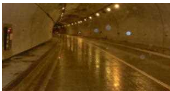
一部凍結したトンネル
