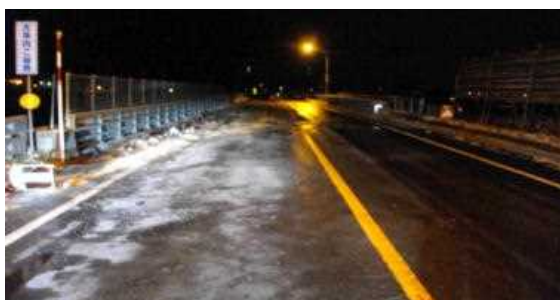
一部凍結した橋の上
